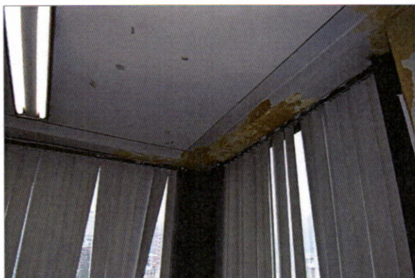
Fotografía No. 015 – Deterioro de estructuras y filtraciones - residencias Tequendama.
