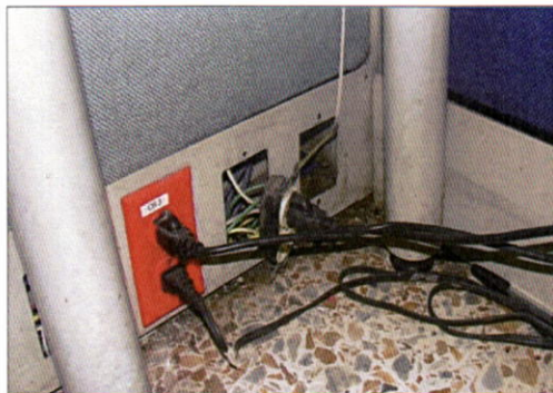
Fotografía No. 007 – sistema eléctrico - Residencias Tequendama.
