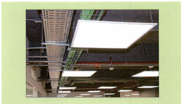
Fotografía No. 008 – Sistema eléctrico CENTRO EMPRESARIAL ELEMENTO.
