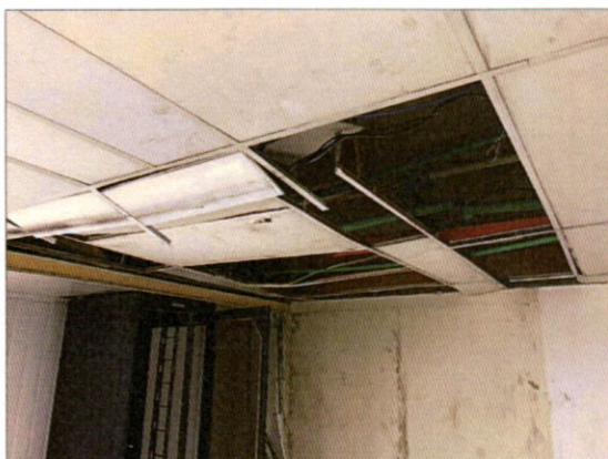
Fotografía No. 009 – Cielo rasos - residencias Tequendama.
